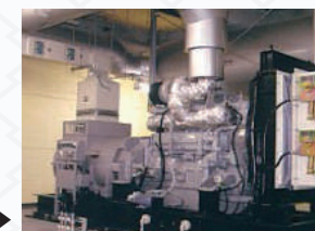
非常用発電機▶
